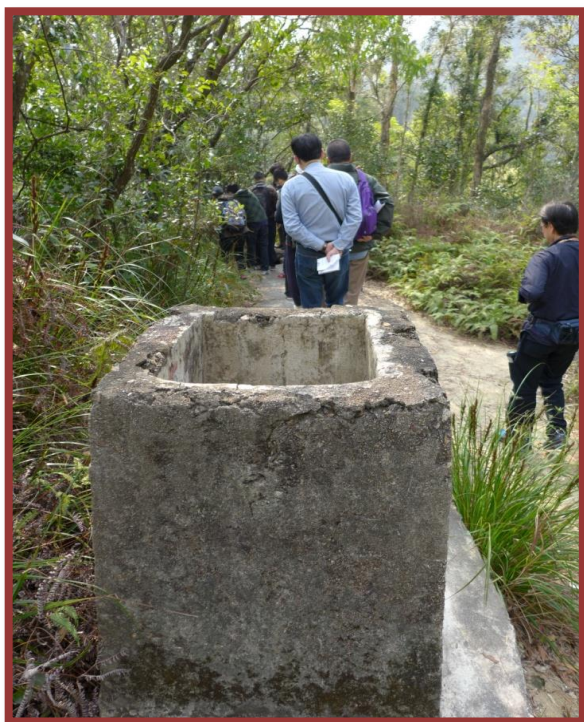
利用「通風口」將空氣輸送入隧道內
