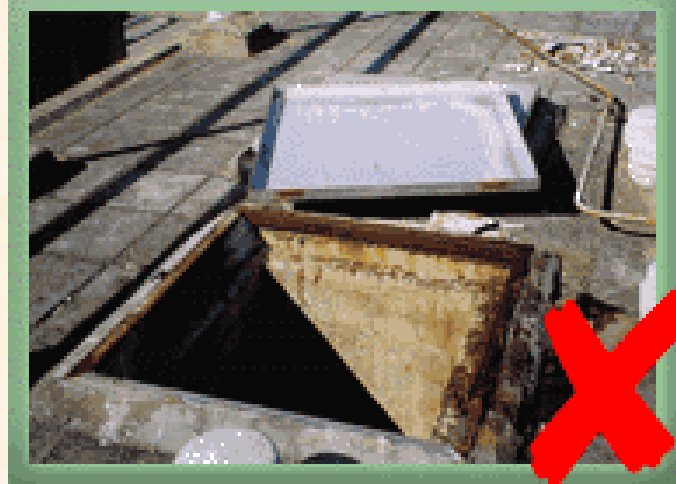
損壞、生鏽及沒有鎖的水箱蓋
