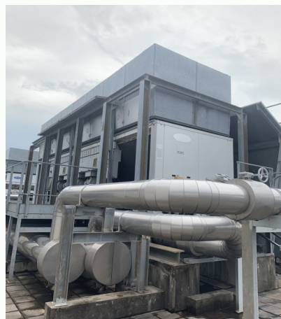
圖 19：九龍塘教育服務中心的氣冷式製冷機將於二零二二年更換為能源效益更佳的水冷式製冷機
